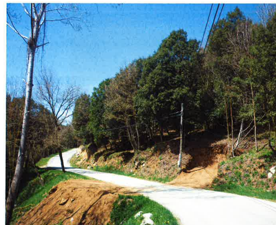
Foto número 8: Línia aèria i pal de fusta de telefònica existent a eliminar.
