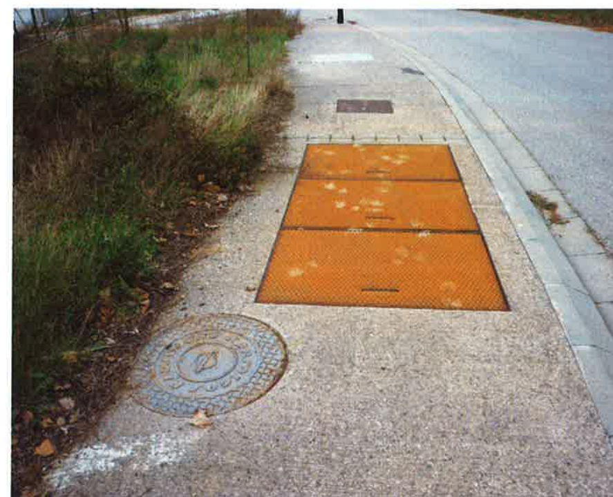
Foto número 15 Arquetes de diferents serveis a respectar sobre voreta del carrer de dalt. Voreta remuntable prefabricada de formigó amb rigola blanca a mantenir.
