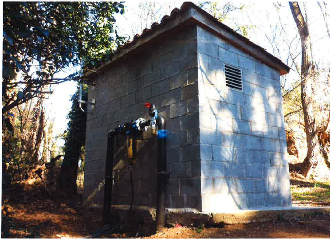
Foto número 9: Imatge de major detall de la caseta de cloració.
