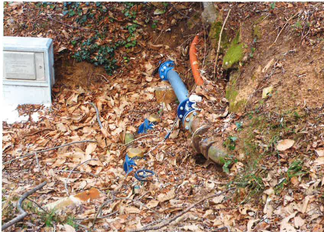
Foto número 10: Tres canonades existents que surten del dipòsit de la Vila (4m 3 ), just al costat de la caseta de cloració.
