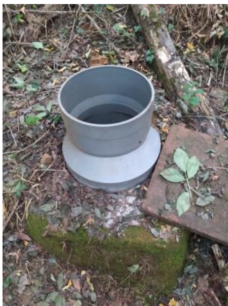
Fig.60 – Vista registre captació G8.0
