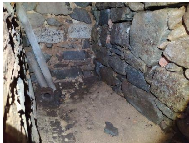
Fig. 77 – Vista interior esquerra de la galeria amb tubs
