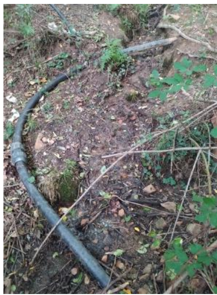
Fig.61 – Tram canonada captació G8.0
