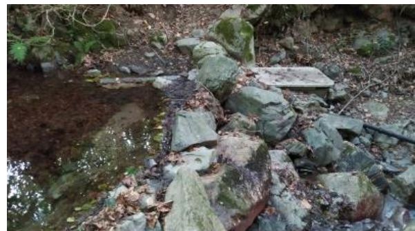
Fig.29 – Vista lateral captació A13
