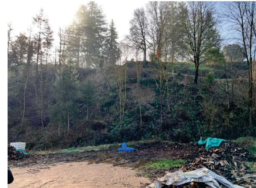
Imatge 2.- Vista del talús afectat per la present memòria.
